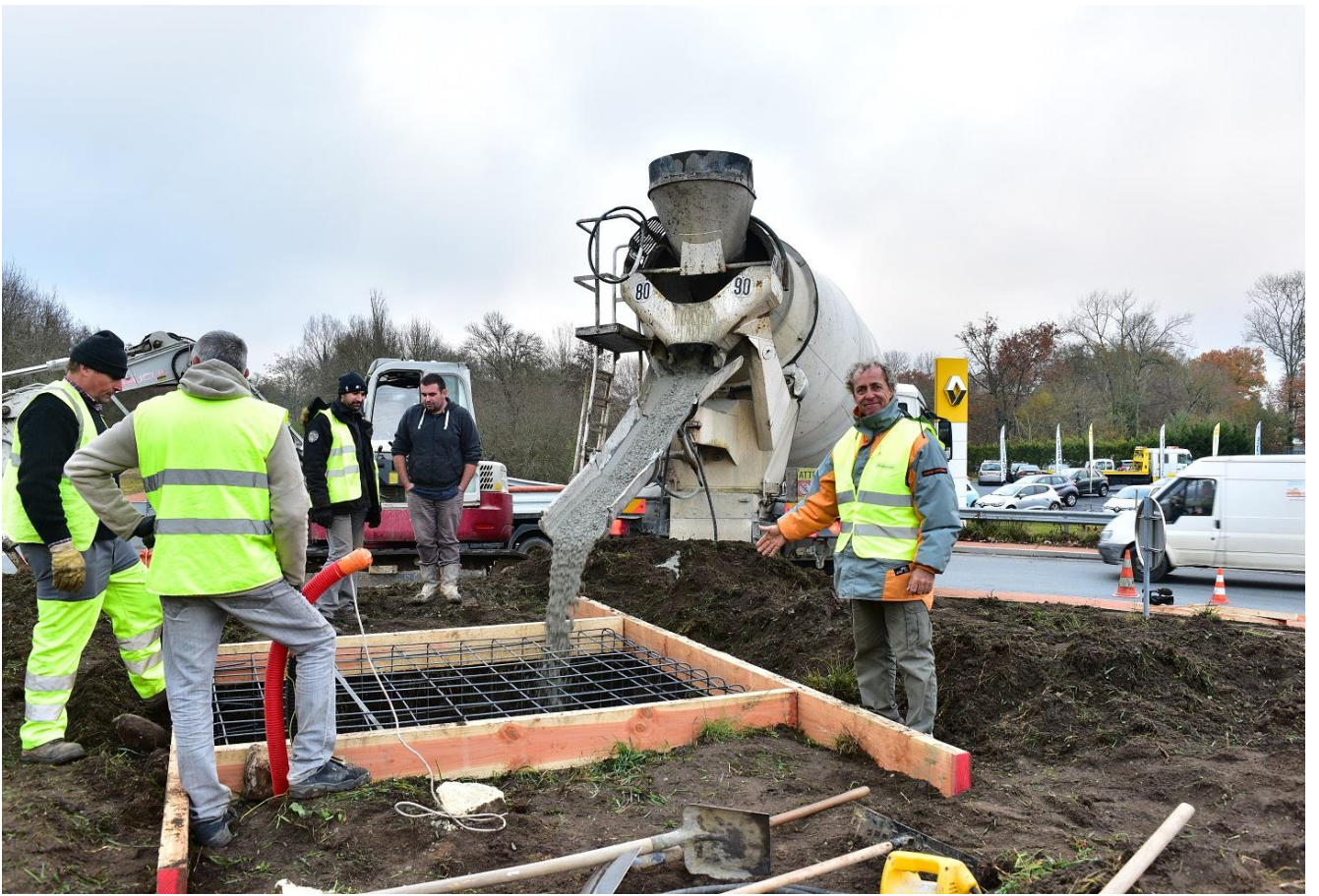
Coulage de la dalle et déchargement de la stèle du rond-point (photos François MAURISSE)
